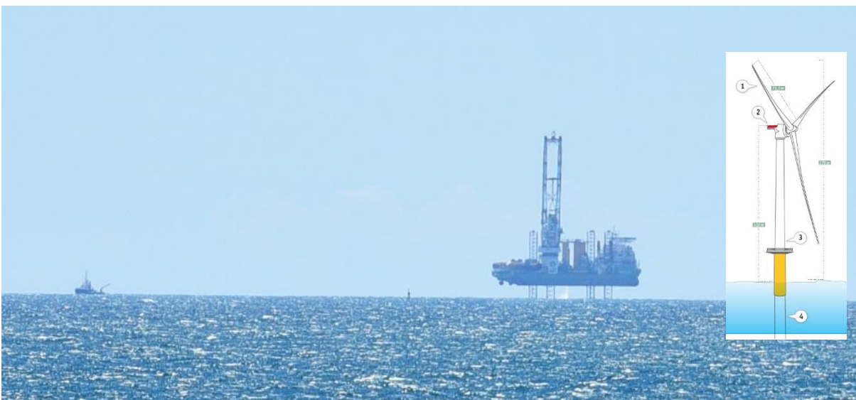
Le navire INNOVATION sur site en opération de pose des fondations (5 mai 2021)
